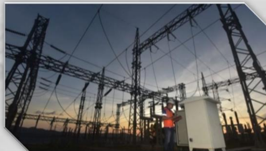
Power Plant PT Perusahaan Listrik Negara Capacity 180 MVA
