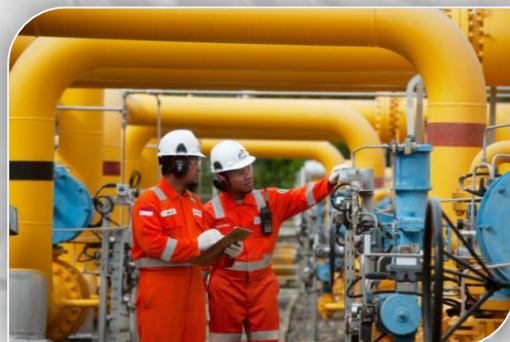
Natural Gas Stasion PT Pertamina Gas Negara Capacity 3600 MMBTUD
